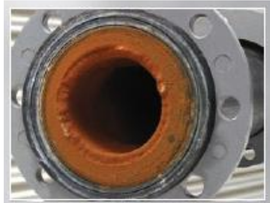
Carbonat belægning med høj del af jernoxid.
